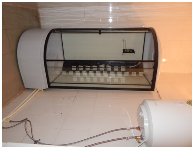
Установленная душевая кабина в комнате личной гигиены спортивного зала с водонагревателем.
